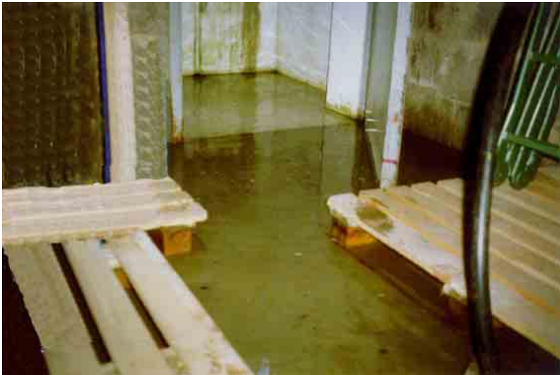
Abbildung 5: Grundwasser in Kellerräumen, Frühjahr 2001 (Aufnahme TGU)
